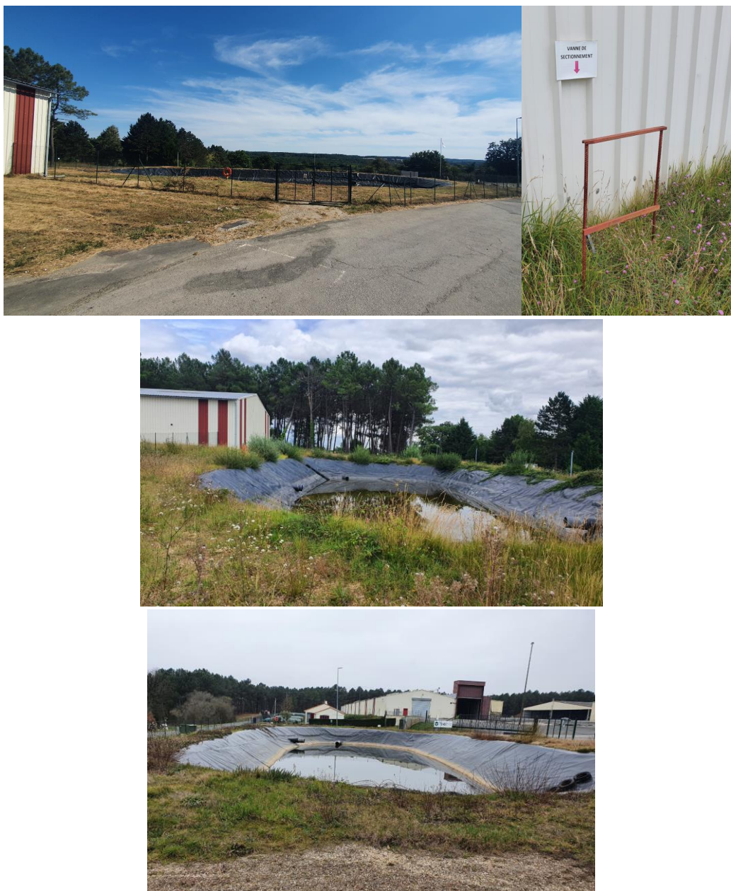
PHOTO 1 : BASSIN DE CONFINEMENT DES EAUX D'INCENDIE COMMUN DU SITE, ACCES ET VANNE D'OBTURATION DU BASSIN EN CAS D'INCENDIE
